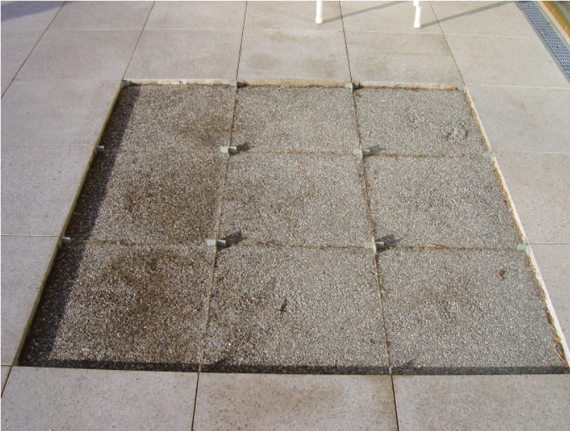
Ständige Unterfeuchtung der Plattenunterseite verursacht auf Dauer permanente dunkle Flecken
